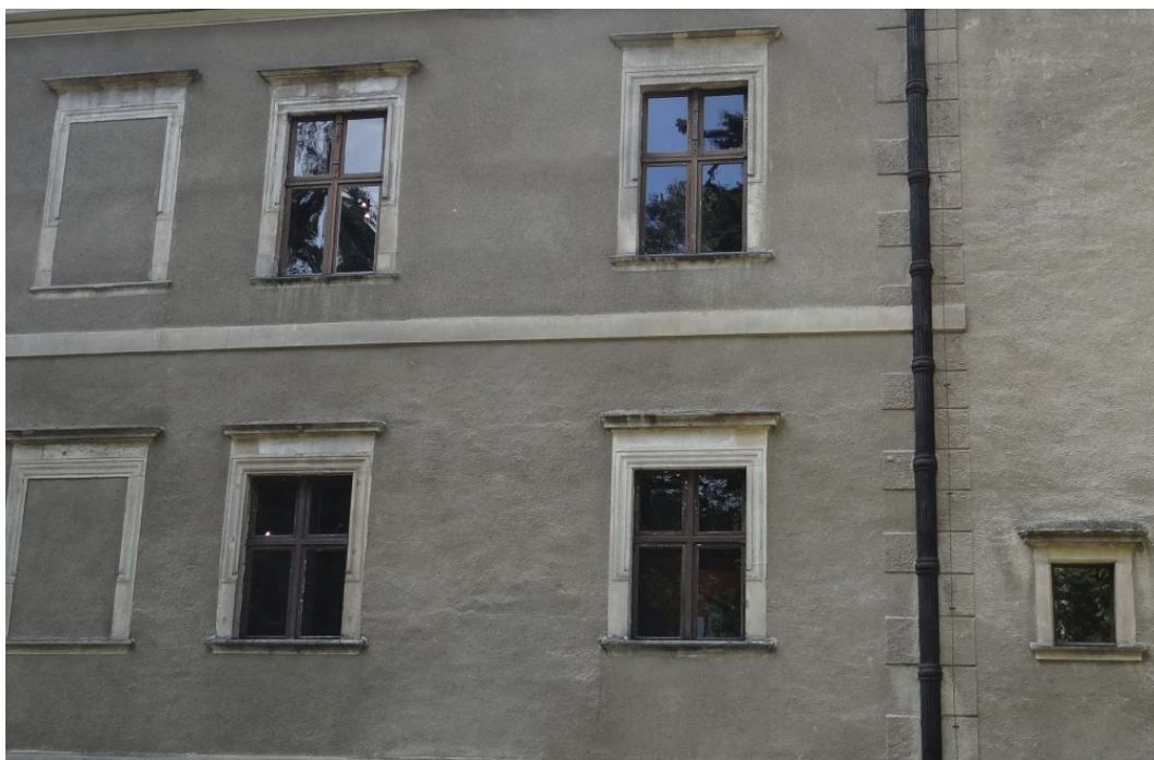
235. Gołuchów, zamek, fragment elewcji wschodniej – obramienia okienne w przyziemiu oraz na I piętrze, stan z 2019 r.
