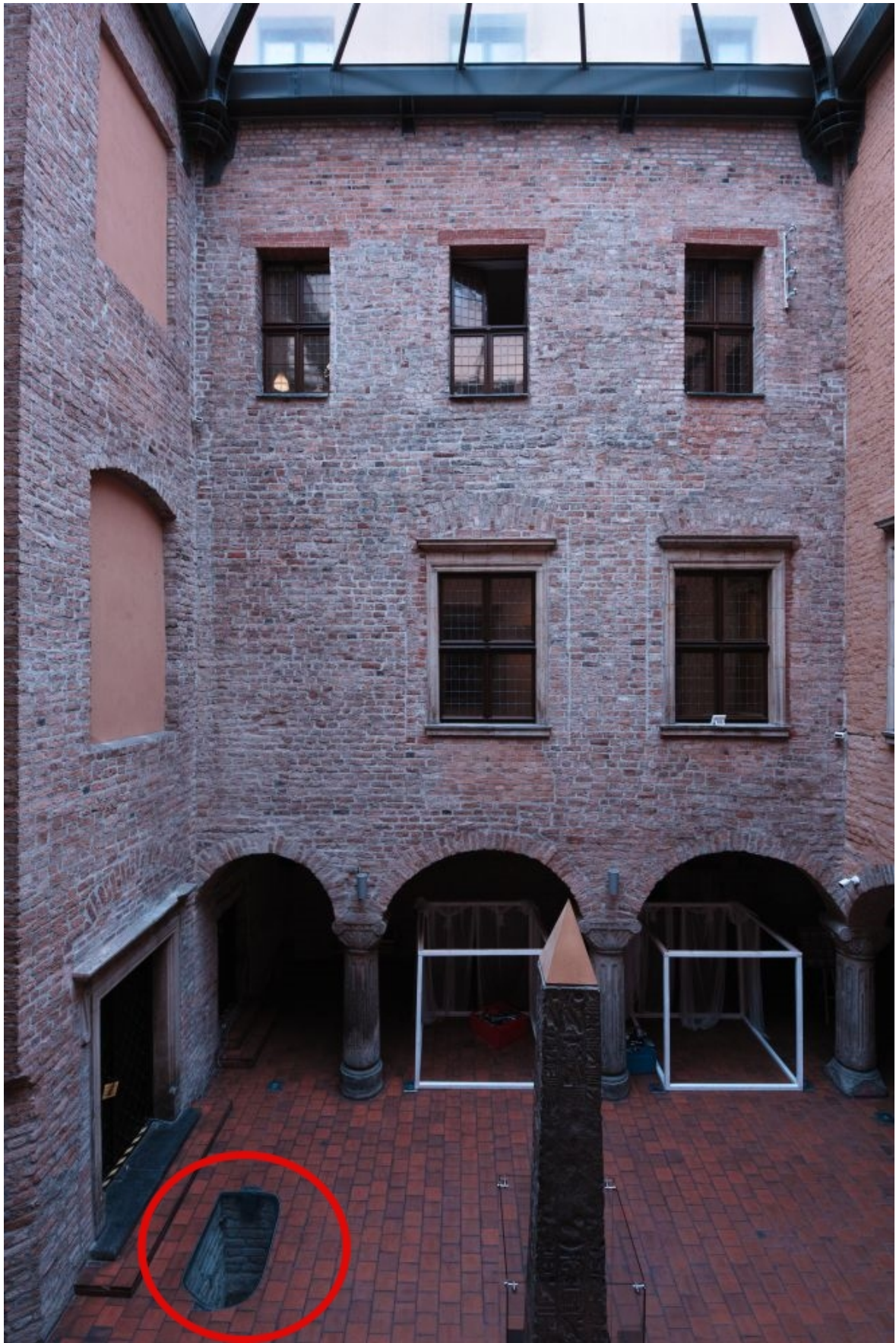
218. Poznań, pałac Górków, dziedziniec, widok z drugiego piętra na elewację południową i fragment elewacji wschodniej, przed wejściem zaznaczono odkrywkę w posadzce, stan z 2022 r.
