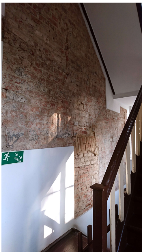
164. Koźmin Wlkp., zamek, ob. klatka schodowa w zachodniej części skrzydła północnego, drugie piętro, ściana wschodnia, fragment tynku z dekoracją malarską (sgraffito), stan z 2021 r.
