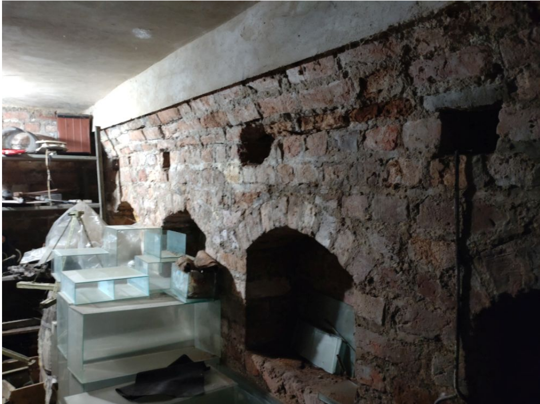
116. Szamotuły, pałac, tzw. „piwniczka” w narożu północno-wschodnim pałacu, fragment ściany zachodniej z wnękami, stan z 2022 r.
