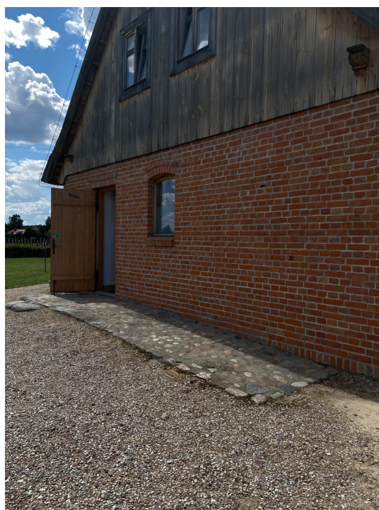
Próba zapewnienia dostępności architektonicznej. Podjazd o niskim nachyleniu, wykonany z kamieni o wygładzonej fakturze, prowadzący do budynku toalet. Niestety drzwi wejściowe są stosunkowo wąskie i mogą sprawiać trudności osobom poruszającym się na wózkach rehabilitacyjnych lub elektrycznych.
