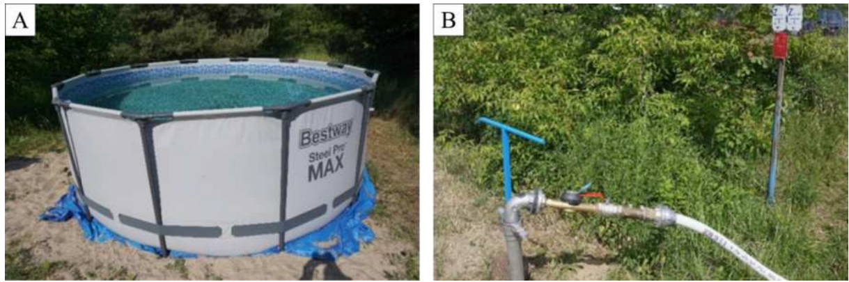
Ryc. 5.10. A) Zbiornik na wodę (8.07.2022); B) Hydrant podłączony do miejskiej sieci wodociągowej (8.07.2022)
