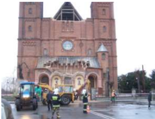
Strażacy podczas katastrofy budowlanej kościoła parafialnego w Lututowie, 2012. Źródło: prywatne archiwum W. Zabłockiego.
