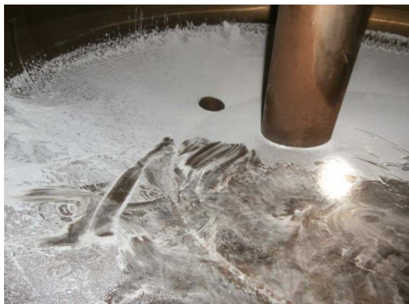
Rys. 24. Zdjęcie zrobione po zatrzymaniu instalacji - - pył na dnie dennicy
